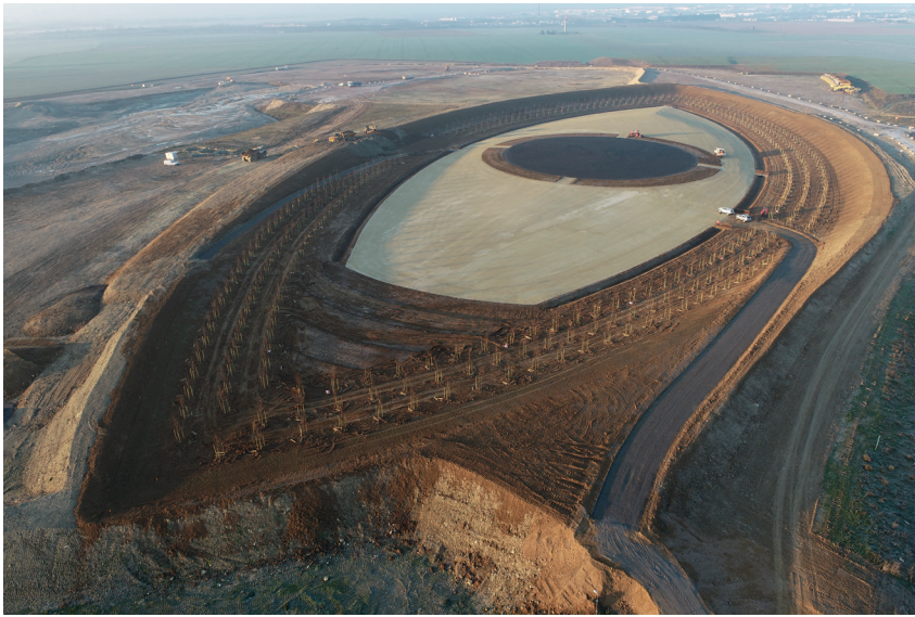
L'œil du ciel, en cours de réalisation, mars 2023 Villeneuve -sous-Dammartin, France © ECT
